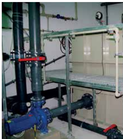
● FILTR PODCIŚNIENIOWY – POMPA. ORUROWANIE Z POMOSTEM OBSŁUGOWYM
