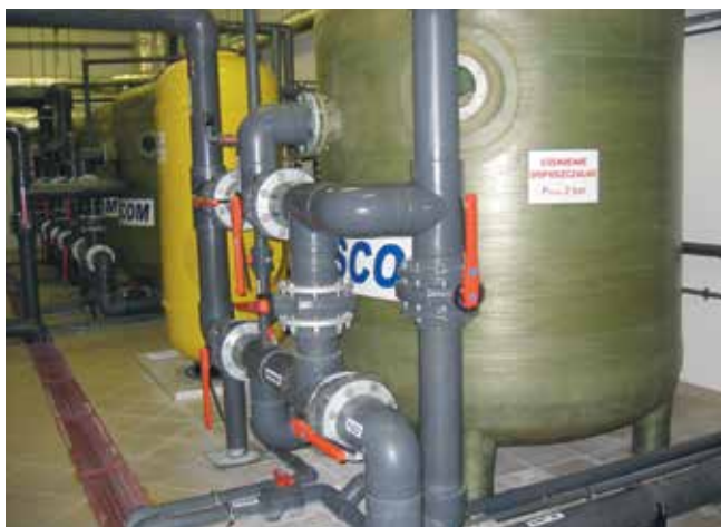
♦ BATERIE FILTRÓW I ZBIORNIK REAKCYJNY
