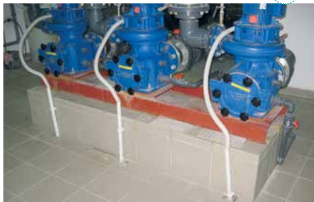
◆ POMPY WODY BASENOWEJ NA PODWÓJNYM FUNDAMENCIE
