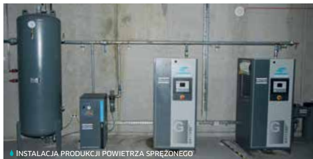
INSTALACJA PRODUKCJI POWIETRZA SPRĘŻONEGO
