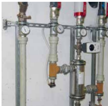
WYMIENNIK Z KSZTAŁTKAMI CZARNYMI – WIDOCZNA KOROZJA
