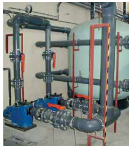
◆ PODBASENIE Z POMPAMI I FILTRAMI
